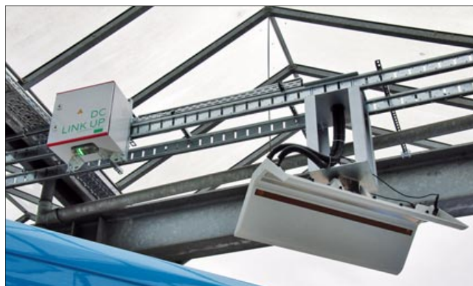
Ladehaube und Container für die Kommunikation zwischen Ladeinfrastruktur und Bus
