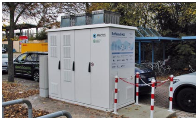
Container des Rotationspeichers auf Betonfundament, platziert im Seitenbereich des ZOB abseits der Bussteige
