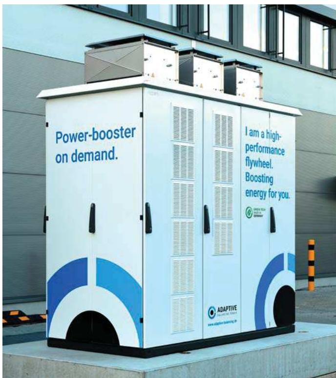
Der Speicher liefert die Leistung, die der Netzanschluss nicht hergibt, um den Strom schnell genug in die Batterien des Busses zu schieben.
