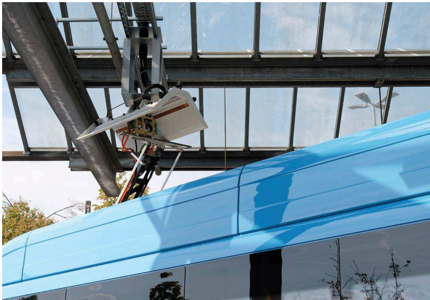
Der Pantograf ist direkt auf dem Bus montiert. Zum Laden fährt er unter die Ladehaube, die an der Überdachung angebracht ist.
